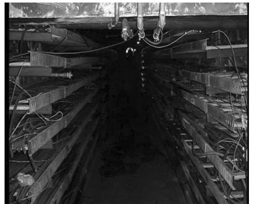
图2 火灾模拟试验电缆隧道内部图片
