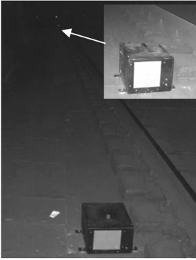
图 3 图像式无砟轨道沉降监测系统现场
