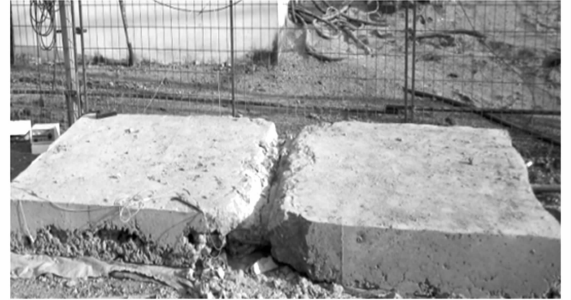
图 8 混凝土产生裂缝的照片
